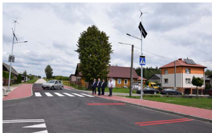
2022. Bezpieczne przejście dla pieszych w Brzezinach. Wspólna inwestycja Gminy Szydłów z Powiatem Staszowskim. Gmina Szydłów pokryła 19% kosztów tj. 41.021 zł.
