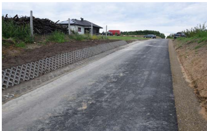
2023. Droga wewnętrzna na dz. nr 141/1. Odcinek 150 m. Wykonano: przebudowę nawierzchni jezdni, budowę poboczy, budowę zjazdów.
